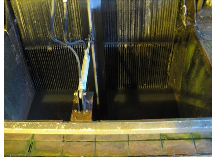
Välppä Viinikanlahden jätevedenpuhdistamolla. Kuva: BMOL ry/Esa Härmä
