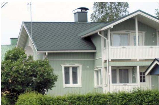
Kuva 3. Liian raskas parvekerakennelma
