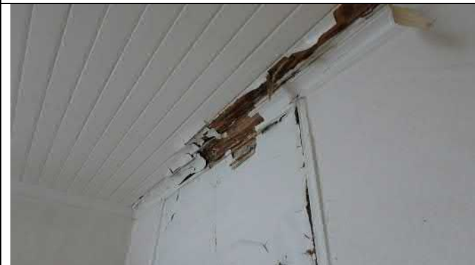
13. 2-kr. savupiipun ympärillä vesivuotovaurioita
