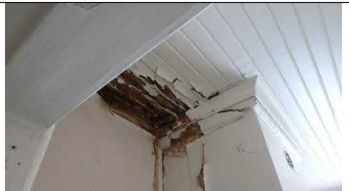
14. 4-kr. savupiipun ympärillä vesivuotovaurioita
