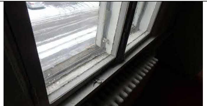
8. 2-krs puuikkunoissa on laajoja lahovaurioita
