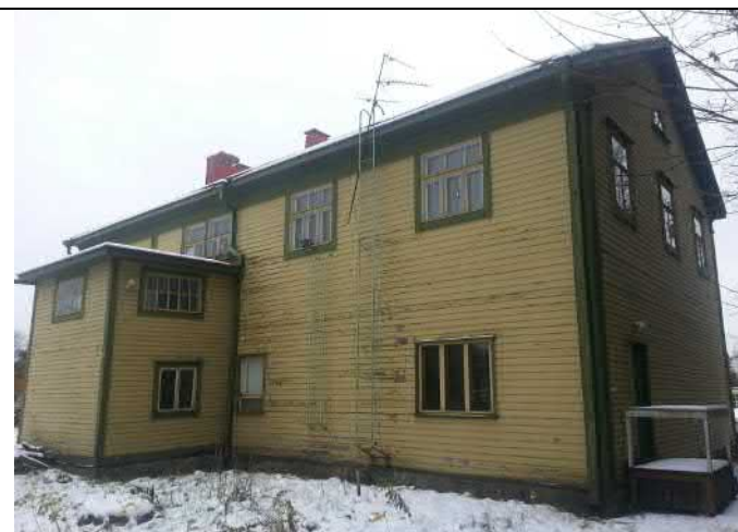
5. Ulkoverhous on huonokuntoinen ja maalipinnoite on irronnut laajoilta alueilta
