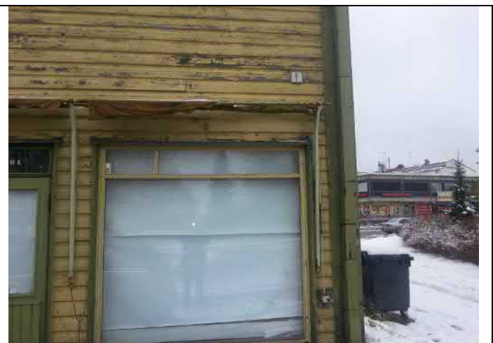
6. Huonokuntoista ulkoverhousta etusivulla
