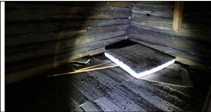
11. 2-kr. varastotilassa laajoja kosteus ja mikrobivaurioita
