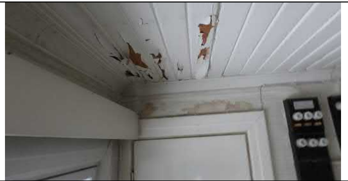
12. 2-kr. portaikon aulassa räystäälínjan vesivuotovaurioita sisäkatossa
