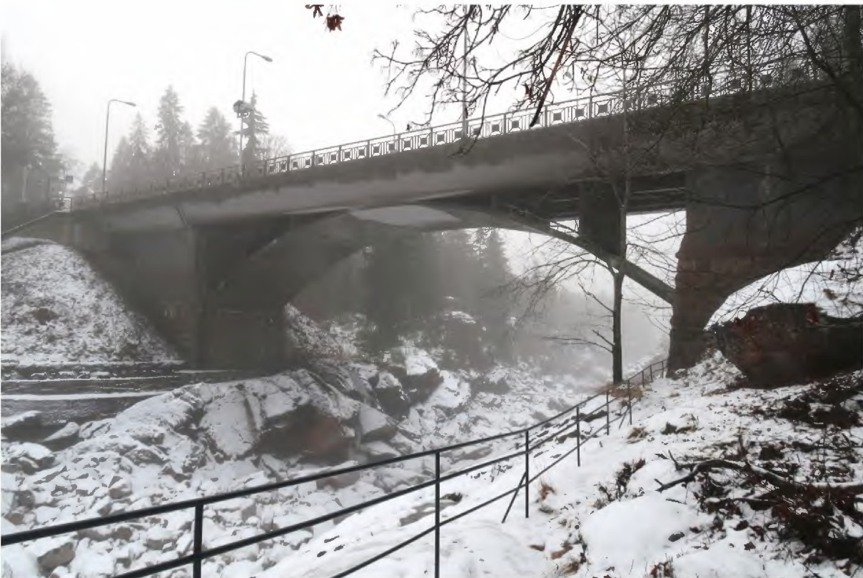
Kuva 37. Kaariholvi on hyvin ohut betonirakenne, mutta levymäisenä rakenteena se näyttää alaviistosta katsottuna raskaalta. Sillan luonteeseen vaikuttaa myös se, että koski on kuiva. Jos koskessa olisi vettä maatukien alaosat olisivat osittain vedessä.
