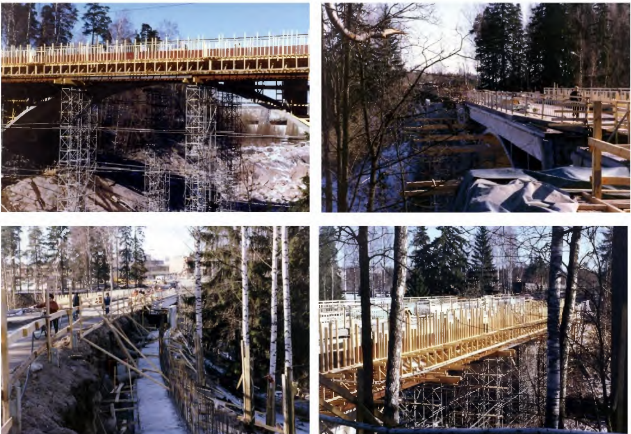
Kuva 20. Kuvasarja Koskisillan leventämisestä ja Imatrankoskentien penkereiden tukemisesta 1978. Kuvaaja Pekka Jyllinvuori, Paul Jyllinvuoren kokoelma, Imatran kaupunginmuseon kuva-arkisto.
