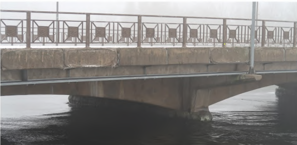
Kuva 26. Lähempää katsottuna 1970-luvulla lisätyt konsolit ja niiden kannattama kevyen liikenteen väylä erottuvat selkeästi vanhoista betonikaarista ja virtapilareista. 1970-luvulla asennettujen reunapalkkielementtien päät ovat alkaneet pakkasrapautua ja reunapalkkielementtien saumamassat irtoilevat.
