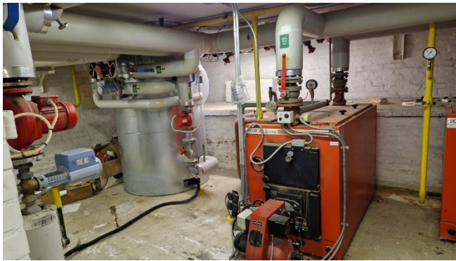
Kuva 15. Käytöstä poistettu kaasukattila järjestelmien.
