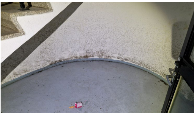
Kuva 3. Porrashuoneen alaosat homeessa.
