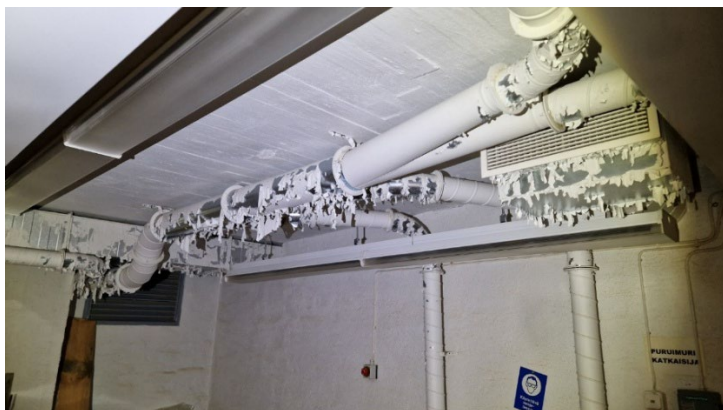
Kuva 17. Ilmanvaihtokanavistojen pinnoitteet ovat vaurioituneet sisäilman olosuhteiden takia.
