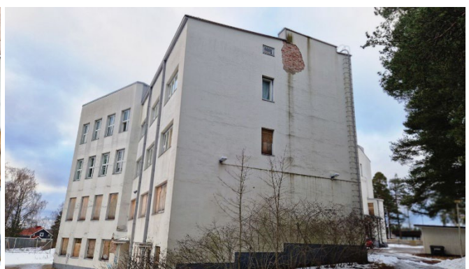
Kuva 8. Pohjoispuolen päätyseinän vauriot.
