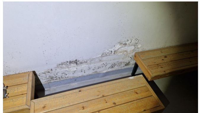
Kuva 12. Pukuhuonetiloiissa maanvastaisen ulkoseinän alaosa vaurioituneet kosteudesta ja silmännähtävää homekasvustoa.
