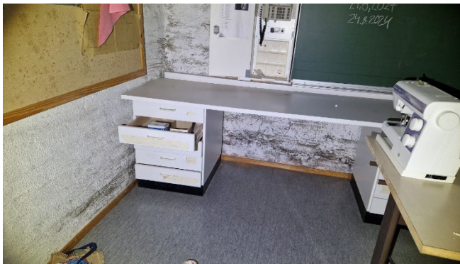
Kuva 11. Suojahuone015, jossa tyttöjen käsityöluokka, seinissä silmännähtävää homekasvustoa.
