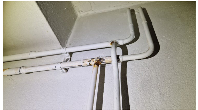
Kuva 16. Lämpölinjan vaurio, 1 krs.
