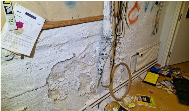
Kuva 1. Teknisen käsityöluokan maanvastaisen ulkoseinän läpi kulkeutuva kosteus on vaurioittanut rakennetta. Silmännähtävää homekasvustoa.
