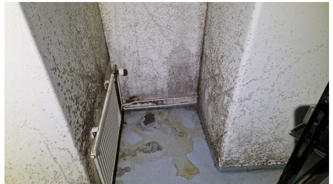
Kuva 2. Kellarikerroksen maanvastainen ulkoseinä. Seinän alaosassa silmännähtävää homekasvustoa.
