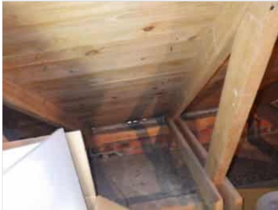
21. Yläpohjan tuulettuminen on osittain puutteellista
