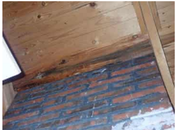
kosteuden aiheuttamia tummentumia hormin läpiviennin kohdalla
