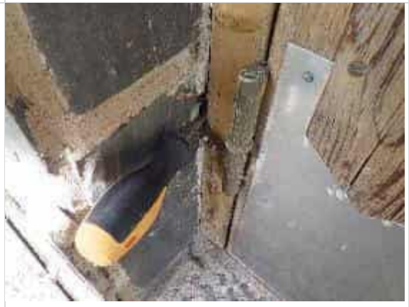
30. Ulko-oven asennuksen tiiveydessä on puutteita.
