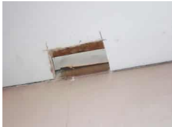
Rakenneavaus urkuparvella(kirkkosali), vesivuoto YP rakenteen ilmansulkukartongin päältä.
