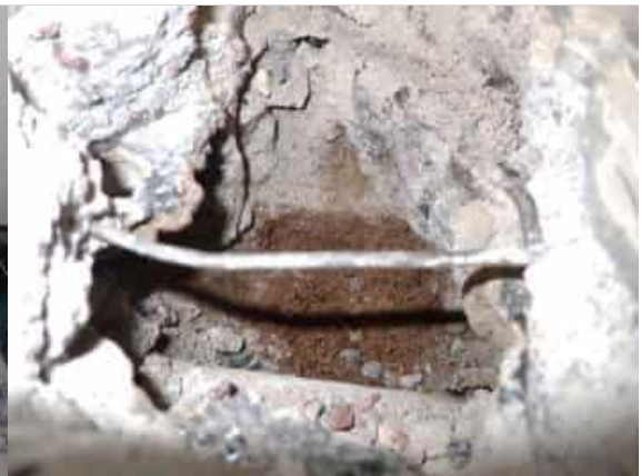
38. Täyttöhiekka pohjalaatan alla, anturaa vasten on vesimärkää.
