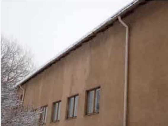
Kosteusjäljet näkyvät selvästi julkisivupinnalla
