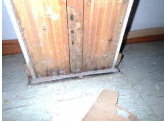
Pilarin alapäässä kosteusjälkiä
