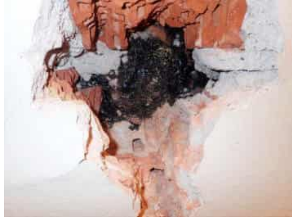
Perusmuurin ja verhomuurauksen väli on täytetty laastilla, ei lämmöneristystä, PM sisäpinnalla bitumisively(PAH yhdisteitä sisältävä)
