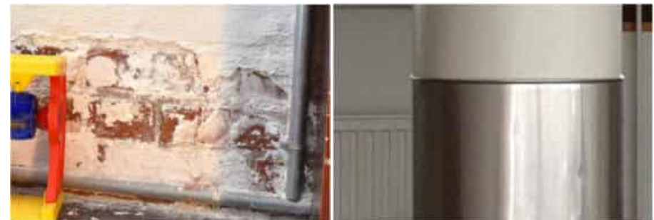
Kuva: Ohutrappaus ja maali. Kosteusvaurioitunut tiiliseinä.
