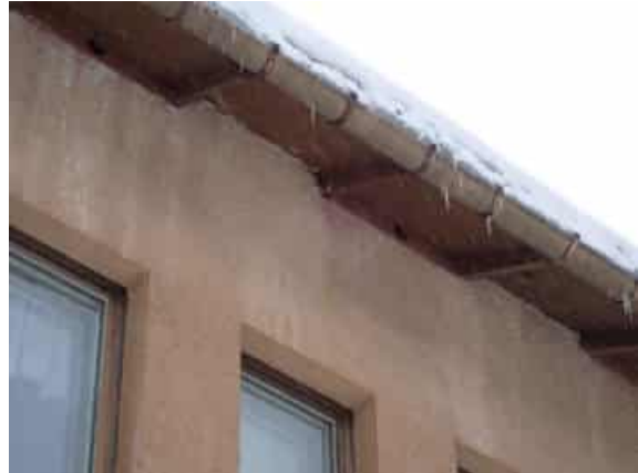
Lähikuva räystästä ja kosteusjäljistä, kosteus valuu YP rakenteesta seinäpinnalle.
