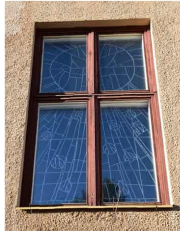
Kuva: Ristikarmi on peräisin 1980-luvun peruskorjauksesta. Alkuperäisissä kirkkosalin ikkunoissa oli vain vaakavälikarmi ja sen molemmin puolin pystyvälipuitteet
