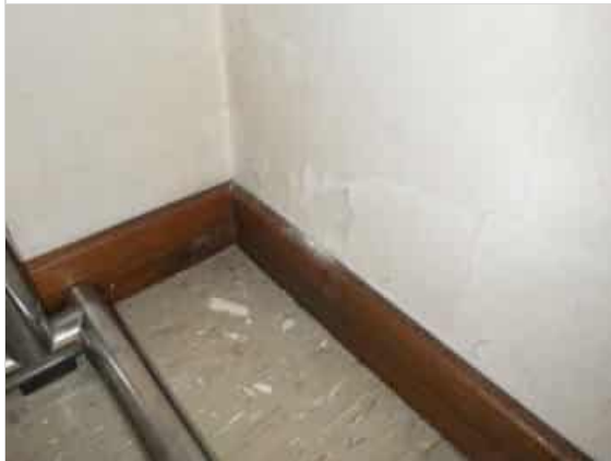
17. Pintatasoitekerrokset ovat irronneet alustasta
