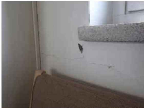
46. Halkeilua kirkkosalin ikkunoiden alla
