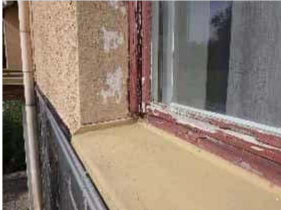
13. Vesipellin liittymä rappaukseen ja ikkunapielestä irtoa maali
