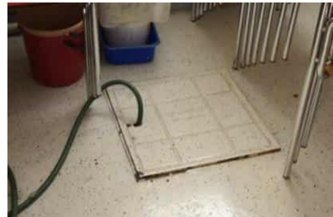
Kuva: Kellarikerroksessa olevan kokoojakaivo.
