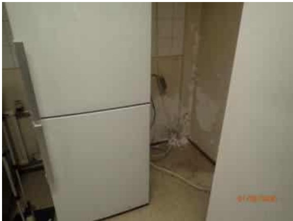
Kosteusvaurioita maanvastaisella seinällä jääkaapin takana
