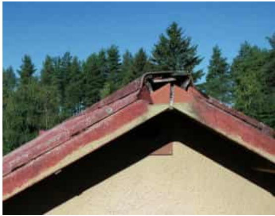
Epätiivis harjan pääty
