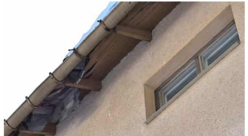
Kuva alhaalla: Vanha ullakkoikkuna. Räystään aluslaudoitusta on lahonnut.
