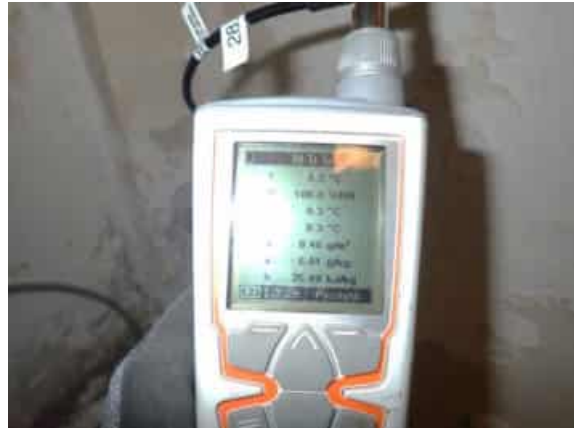
Mittaustulos RH% 100, vettä mittausputken juuresta lattialle.
