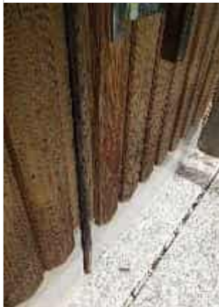
29. Ulko-ovi ulkopuolelta kuvattuna, lehtien välissä selvä rako
