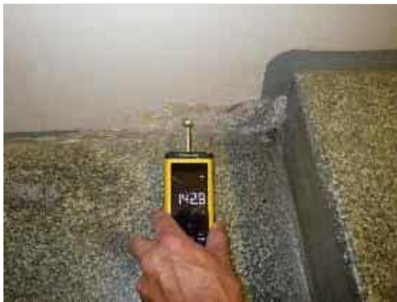
15. Kosteusjälkiä WC rappujen väliseinän alaosassa
