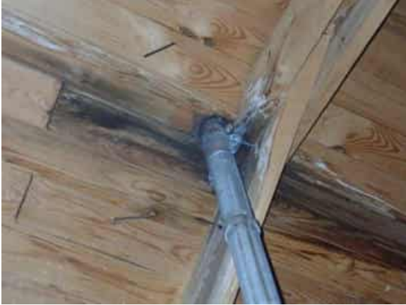
Kosteusjälkiä antennin läpiviennin kohdalla
