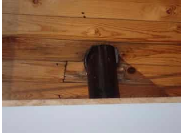
Kosteusjälkiä viemärin tuuletusputken läpiviennin kohdalla
