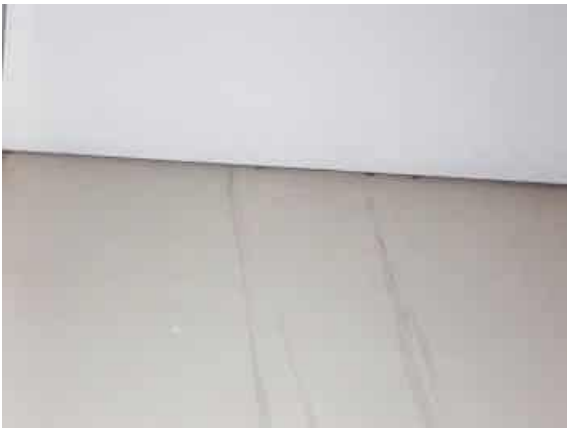
Vuotojälki kirkkosalin ulkoseinä/YP liittymästä
