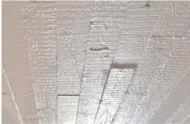
Kuva: Kattilahuoneen kattoon on jätetty näkyville välipohjan lautamuotin jäljet.
