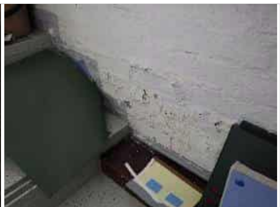
6. Kosteusvauriojälkiä askartelutilan perusmuurin sisäpinnalla
