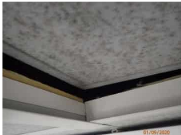
Harmaita pistemäisiä värimuutoksia alakattolevyssä
