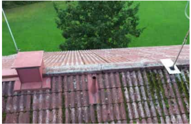
Epätiiviitä vesikatkon liittymiä
