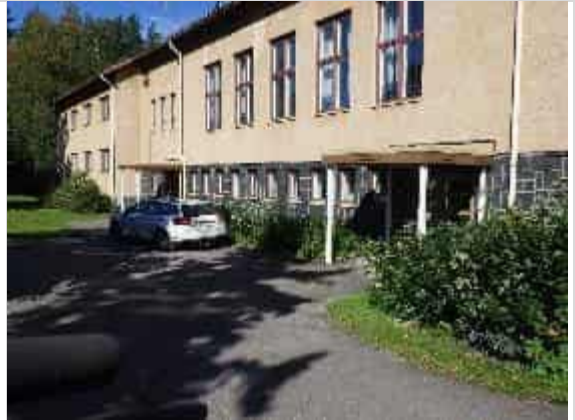
14. Vaaleana jään vaurioittama seinäpinta kuvan keskellä/yläreuna
