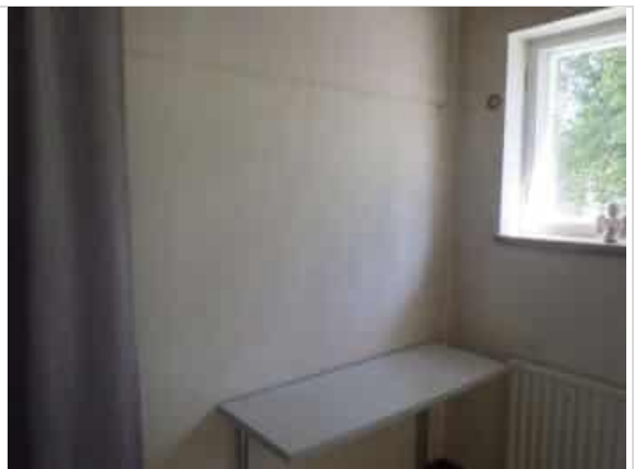
16. Väliseinän halkeilua ja pinttynyttä likaa seinällä
