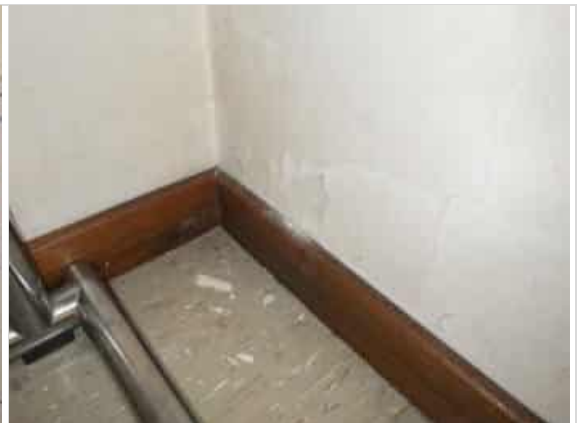
44. Eteistilan ulkoseinärakenteen pinnoitevaurioits
