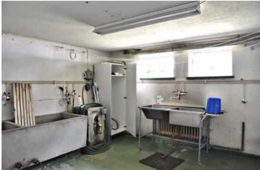
Kuva: Kellarikerroksen pesutupa. Kellarikerroksessa on jäljellä alkuperäisiä valurautaisia pylväsradiaattoreita.
