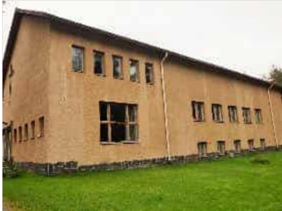
11. Maalipaikkaukset näkyvät vaaleampina. Näillä kohdilla talvella jäätä seinäpinnalla
