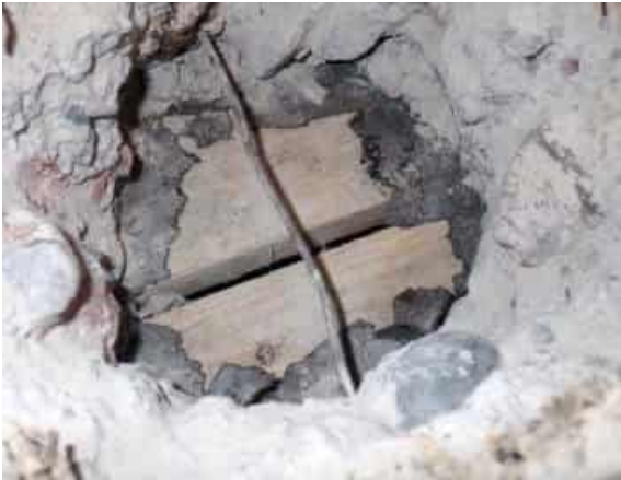
Rakennuksen pitkällä sivulla on putkikanaali AP rakenteen alla/sivulla, kanaalin muottilautojen päällä PAH yhdisteitä sisältä bitumipahvi.
