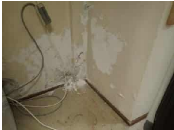
Kosteuden aiheuttamia pinnoitevaurioita jääkaapin takana
