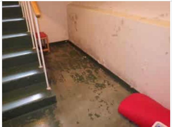
10. Asunto-osan rappukäytävän pinnoitteet ovat vaurioituneen kosteuden vaikutuksesta.
