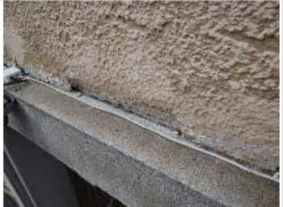
12. Rappauksen liittymän vaurio julkisivussa, aiheuttaja vanha sähkökaapelin kiinnitys
