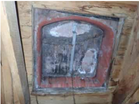
Kosteusjälkiä vesikaton luukun kohdalla
