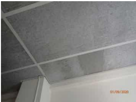
Alakattolevytyksen alapinnalla olevia värimuutoksia
