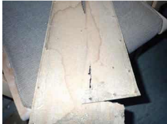
Kosteusjälkiä ylempää pilarista
