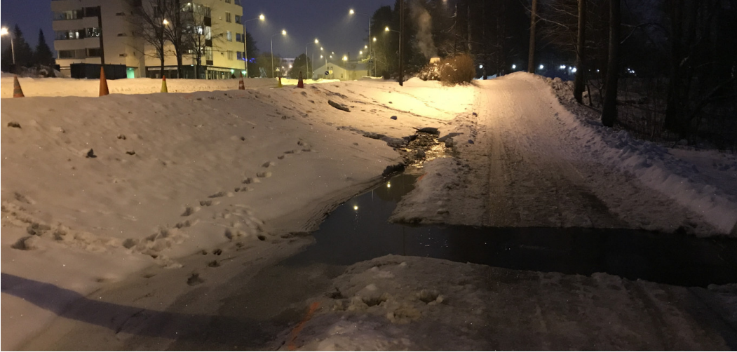
Putkirikko Imatrankoskella, Viipurintien varressa
