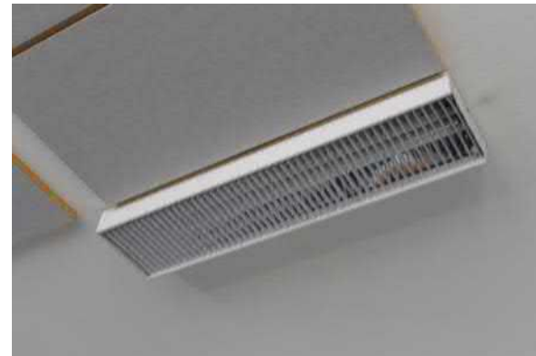
Valaisimet ovat pääosin uusittuja loisteputkivalaisimia.
