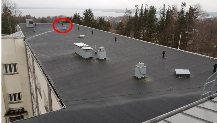
Kuva 20. Näkymä vesikatolle, kuvaan merkitty puutteellisen alipainetuulettimen kohta.
