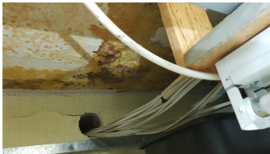
Kuva 18. 3 krs. käytävän alaslaskukaton yläpuolen kosteusjäljet
