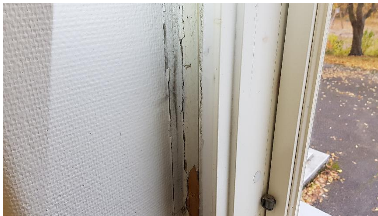
Kuva 15. Vuotojälkeä ikkunapielessä ja nykyinen karmiasennus vanhan karmin päälle.
