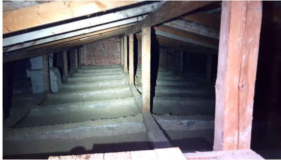
Kuva 16. Alalaattapalkisto on nähtävillä päätyosan korotetussa ullakkotilassa. Eristämätön betonirakenne aiheuttaa kylmäsilän sisäkaton rakenteeseen.
